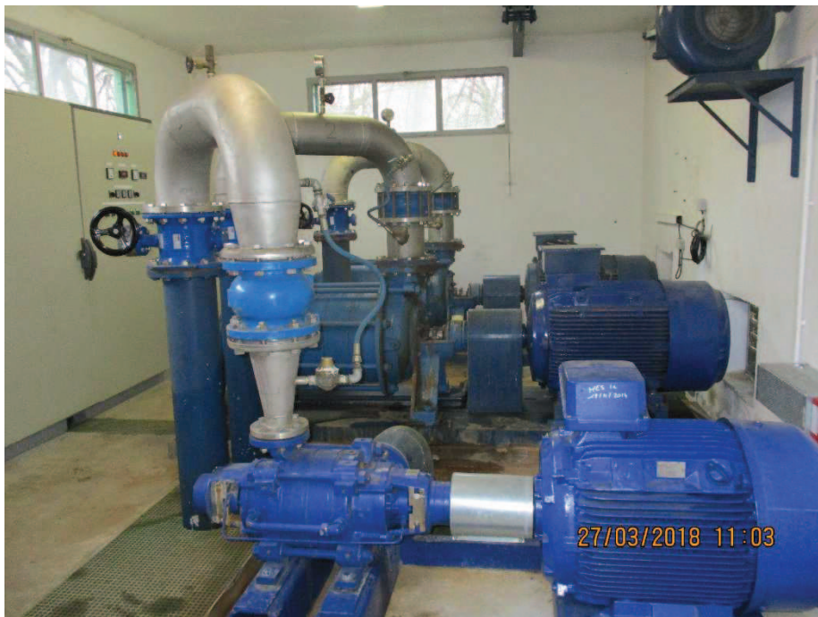
Figure 18 : Pompes de refoulement de Pont Saint Yves
